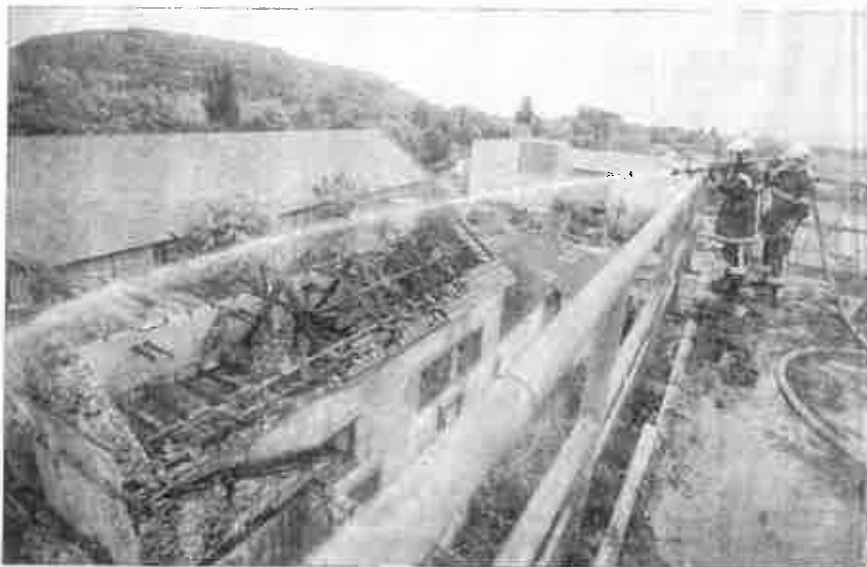
Ph. M. Au plus fort de l'incendie, les sapeurs-pompiers avaient déployé quatre lances.
