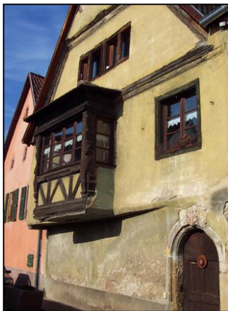
Dans le noyau ancien, de nombreuses maisons présentent des oriels et/ou des encorbellements. Ce type d'architecture a permis de compenser le manque de place dans l'enceinte des villages fortifiés tels que Turckheim, en augmentant à l'étage supérieur la surface habitable.
